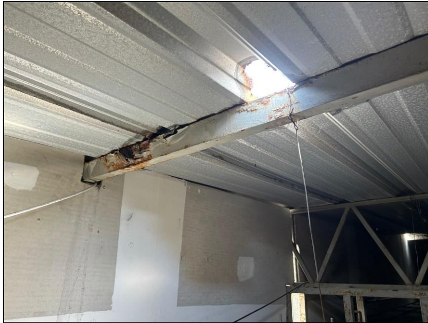
Imagen N° 5: Se muestra el avance del daño en la cobertura liviana metálica tipo TR4 y la viga metálica de soporte.
