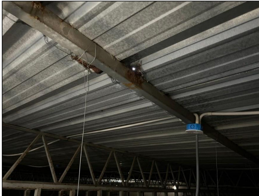
Imagen N° 8: Se muestra el avance del daño en la cobertura liviana metálica tipo TR4 y la viga metálica de soporte.
