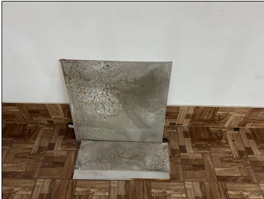
Imagen N° 24: Caída de baldosas desde el cielorraso.
