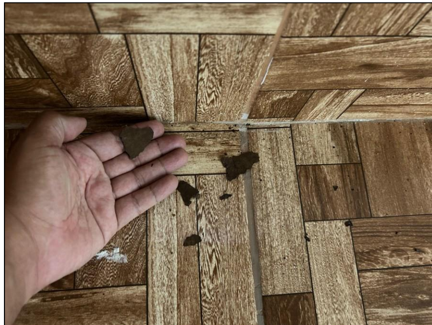
Imagen N° 22: Evidencia (caída vertical continua y progresiva) debido al efecto de la corrosión.
