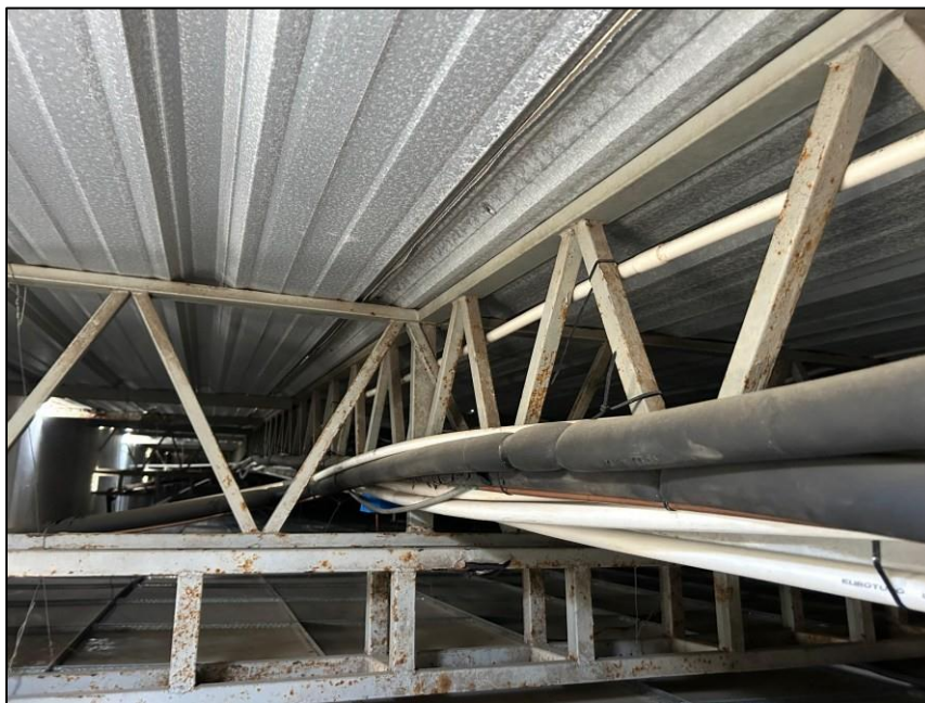
Imagen N° 14: Se muestra el avance del óxido generalizado en las vigas metálicas, cerchas y correas metálicas.
