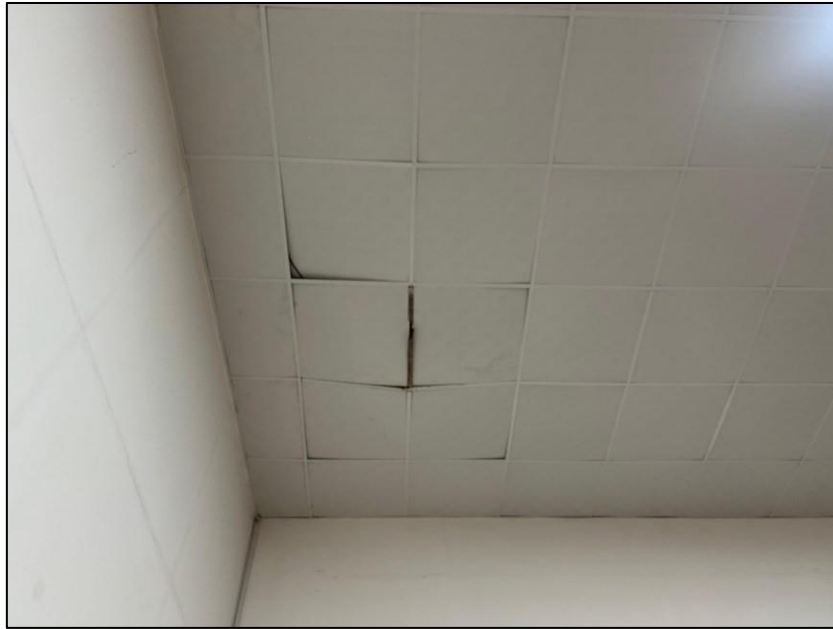
Imagen N° 21: Se muestra evidente daño progresivo comparado a la anterior inspección in situ.
