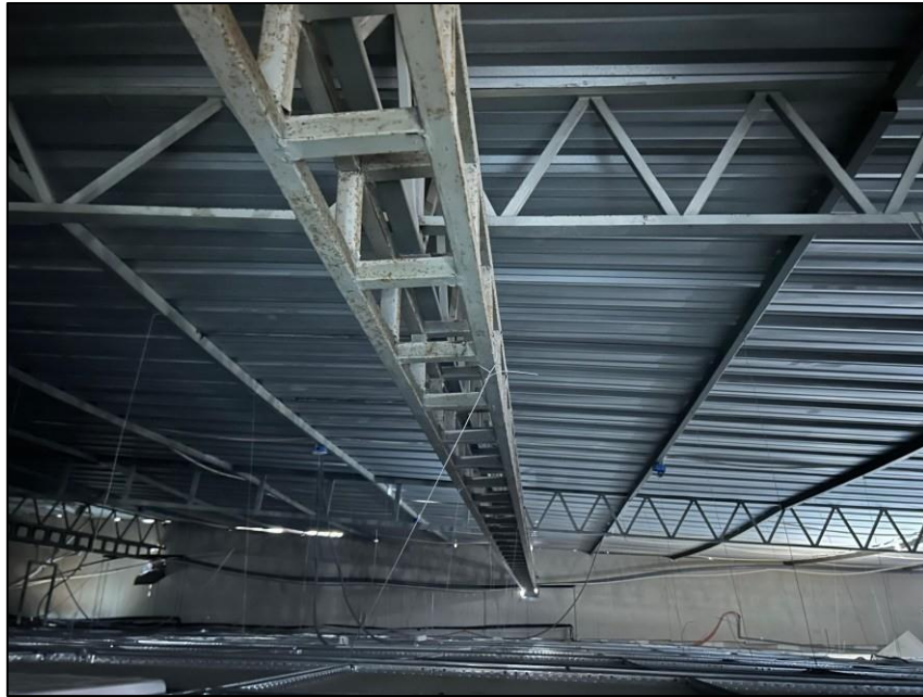
Imagen N° 13: Se muestra el avance del óxido generalizado en las vigas metálicas, cerchas y correas metálicas.
