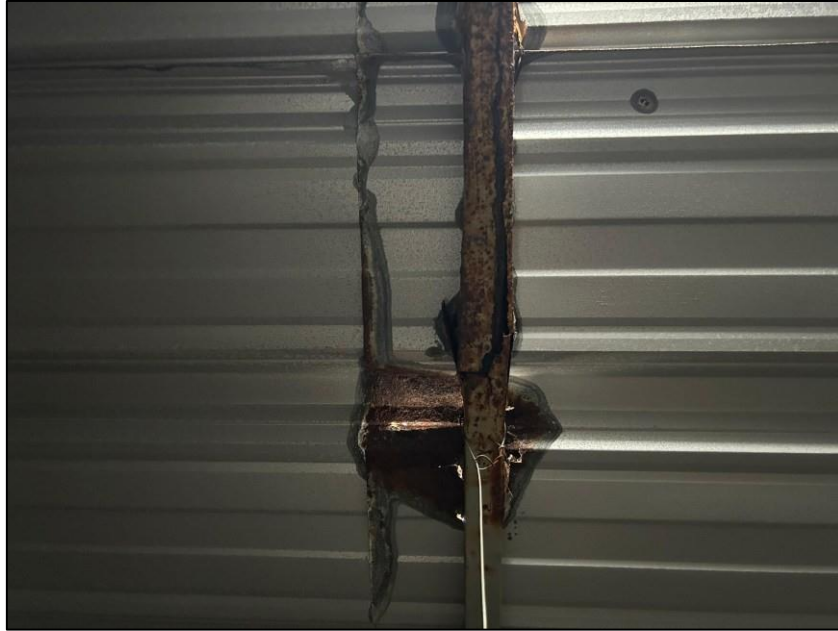
Imagen N° 3: Se muestra el avance del daño en la cobertura liviana metálica tipo TR4 y la viga metálica de soporte.
