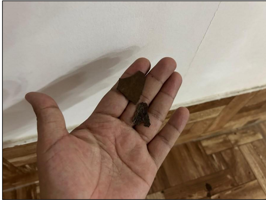
Imagen N° 23: Evidencia (caída vertical continua y progresiva) debido al efecto de la corrosión.
