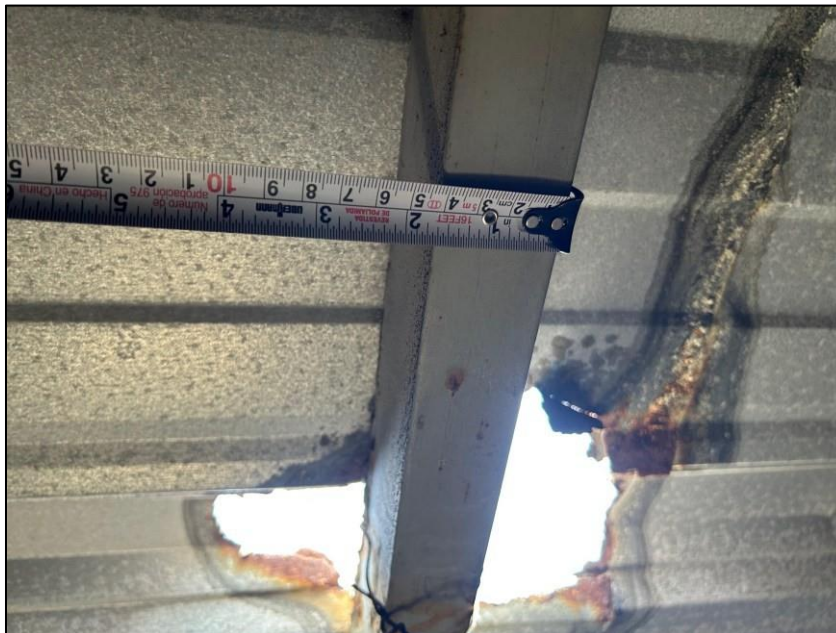
Imagen N° 6: Se muestra el avance del daño en la cobertura liviana metálica tipo TR4 y la viga metálica de soporte.
