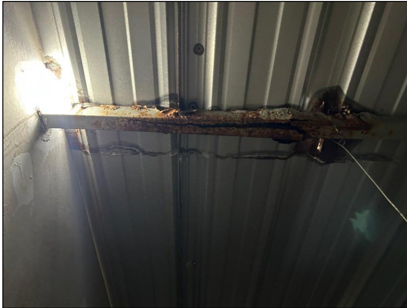
Imagen N° 1: Se muestra el avance del daño en la cobertura liviana metálica tipo TR4 y la viga metálica de soporte.
