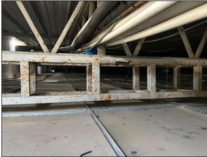
Imagen N° 15: Se muestra el avance del óxido generalizado en las vigas metálicas, cerchas metálicas.
