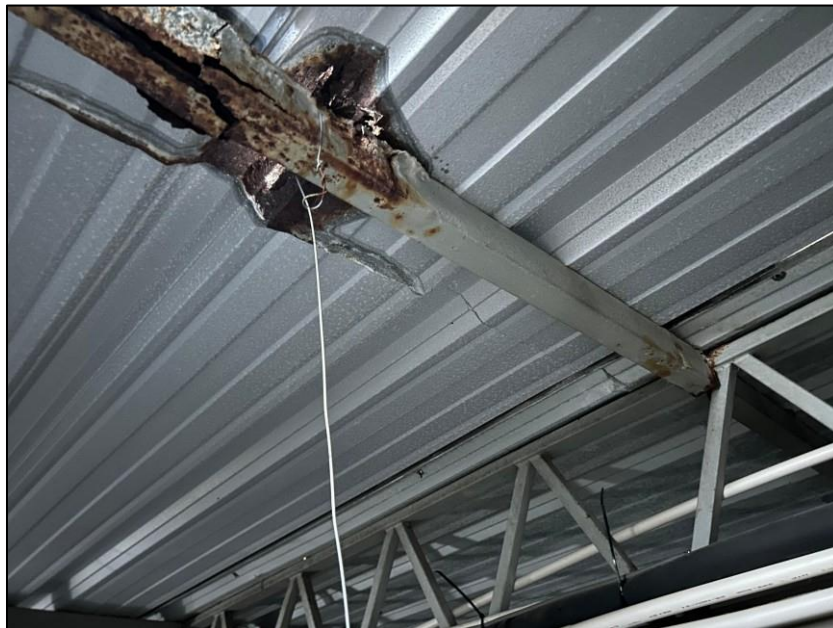
Imagen N° 2: Se muestra el avance del daño en la cobertura liviana metálica tipo TR4 y la viga metálica de soporte.
