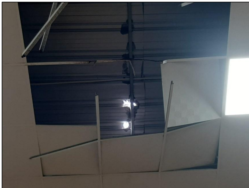
Imagen N° 17: Se observa un nuevo punto crítico de afectación en la zona de cielorraso-cobertura liviana metálica. (esta zona dañada se evidenció con el retiro del cielorraso)
