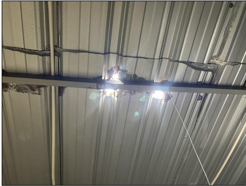
Imagen N° 11: Se muestra el avance del daño en la cobertura liviana metálica tipo TR4 y la viga metálica de soporte.
