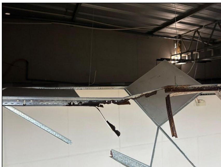
Imagen N° 20: Se observa el deterioro de los soportes metálicos que componen el sistema suspendido en donde se apoya el cielorraso (baldosas). Esta zona dañada se evidenció con el retiro del cielorraso.
