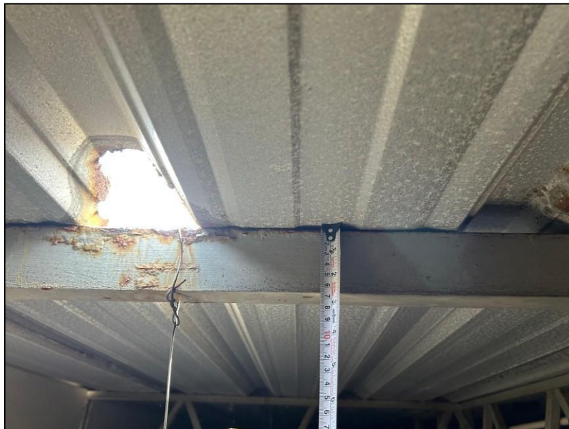
Imagen N° 4: Se muestra el avance del daño en la cobertura liviana metálica tipo TR4 y la viga metálica de soporte.
