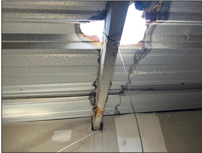
Imagen N° 7: Se muestra el daño en la cobertura liviana metálica tipo TR4 y la viga metálica de soporte.
