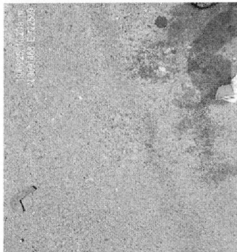
Imagen n.º 17: Peladura de la capa de asfalto en caliente de 2", en calle Alfredo Tello, en coordenadas N 9091468 E 722559.
