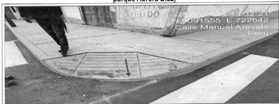
Imagen n.° 47: Desnivel de 5 cm en rampa.
