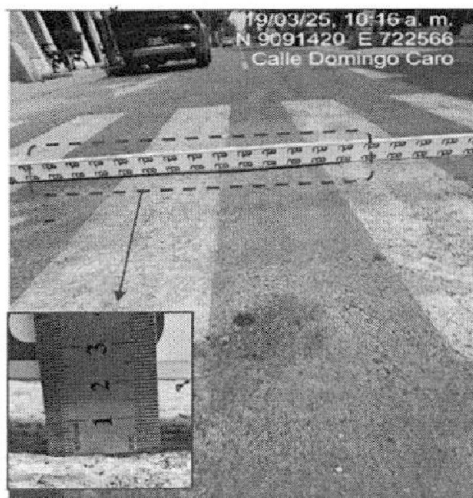
Imagen n.º 14: Depresión de 2,1 cm (regla colocada perpendicular a la vía) en calle Alfredo Tello, carril izquierdo (entre calle Antenor Orrego y calle Manuel Arévalo), coordenadas N 9091420 E 722566.
