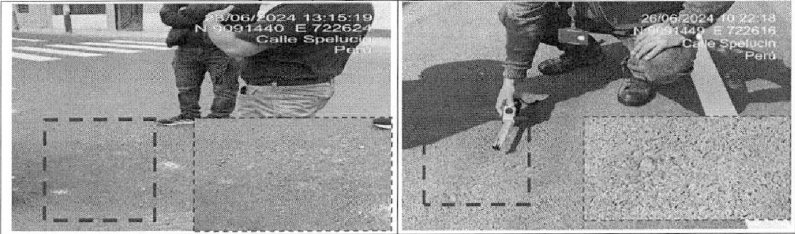
Imagen n.° 10: En la calle Spelucín se evidencia el desprendimiento de material de la capa del pavimento.
