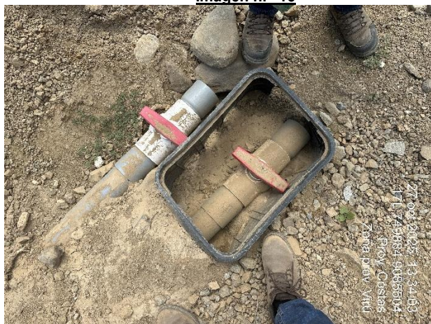
Vista de la caja polietileno para válvula de la señora Hilda Luciano Rosado – R7 (Ubicada en el distrito de Virú)
